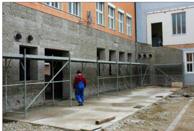
Im Erdgeschoss des Altbaus werden Küche und Speisesaal eingebaut. An der Außenmauer ist bereits die Bodenplatte für den Stahl/Glas-Anbau betonierte, der die Mensa ergänzen wird.
